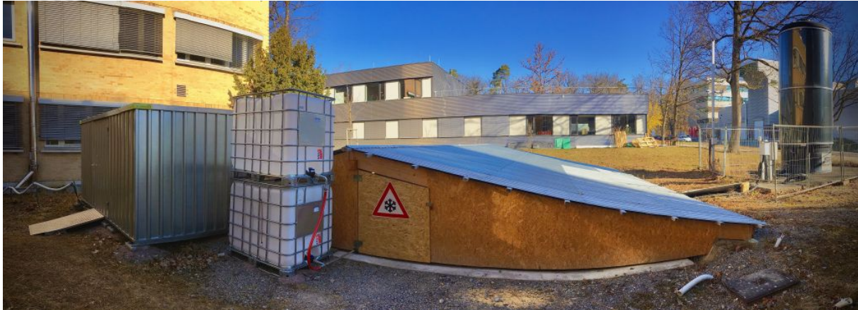
Abb. 2: Versuchseisspeicher im Außenlabor des IGTEs
