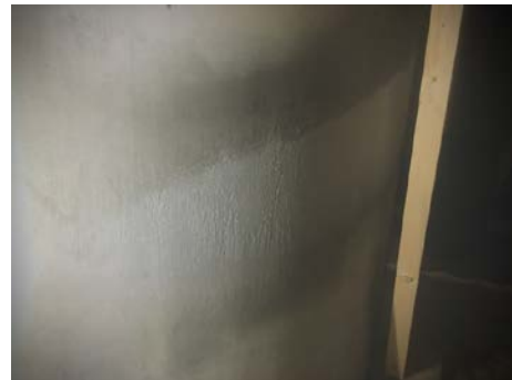
Abb. 21: Frostbildung an der Speicheraußenwand
