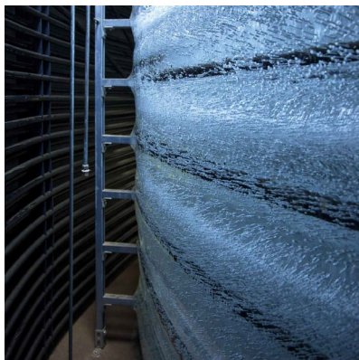
Bild: Eisbildung im Eisspeicher. Quelle: Viessmann
