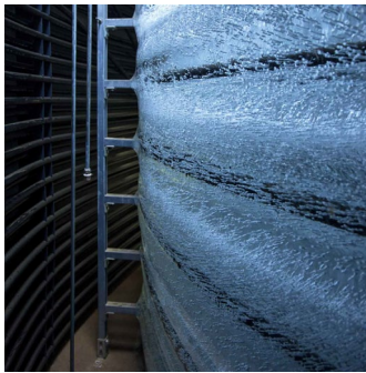
Bild: Eisbildung im Eisspeicher. Quelle: Viessmann
