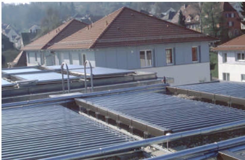
Bild 12: Vakuumröhren-Kollektorfeld in Schwäbisch-Gmünd (100 m 2 )
