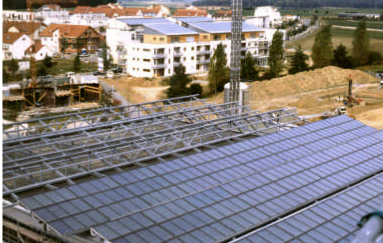
Bild 9: Kollektoren auf der Sporthalle in Neckarsulm-Amorbach
