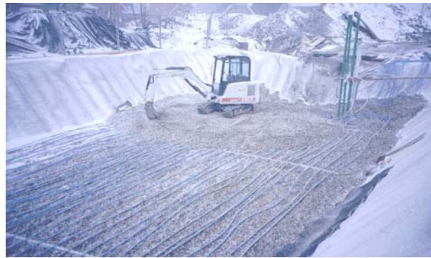
Bild 1: Rohrschlängensystem im Kies-Wasser Speicher Steinfurt Borghorst (1999)
