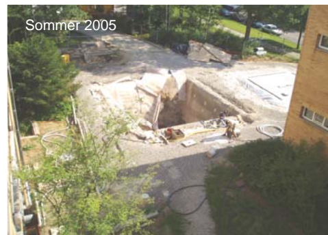
Bild 1: Außenlabor mit Forschungspeicher am ITW; oben Labor 1: Heißwasser-Erdbecken-Wärmespeicher mit aufschwimmender Abdeckung, Labor 2 Kies-Wasser-Wärmespeicher; unten Labor 1 nach Rückbau
