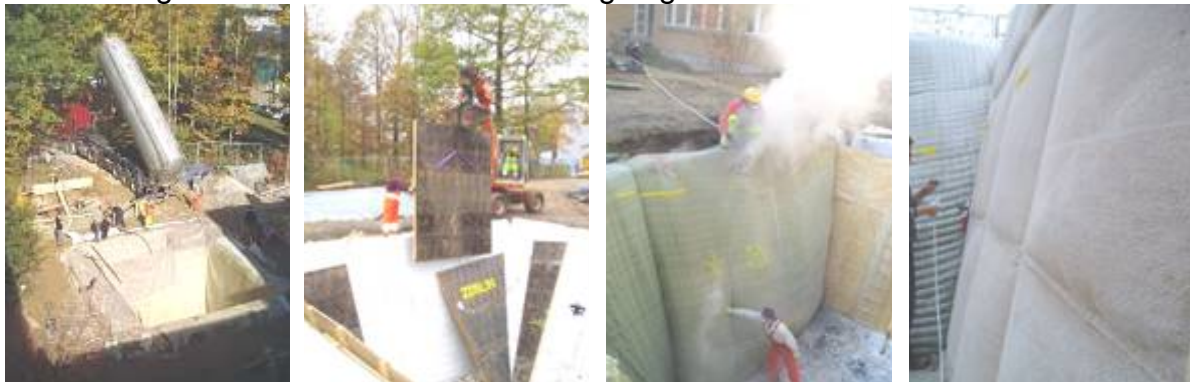
Bild 2: Einbauvarianten für schüttfähige Wärmedämmung, von links nach rechts: Einblasen der Dämmung aus einem Silo-LKW, vorgefertigte Schalungselemente beim Einbau, Einblasen der Dämmung in Geocontainer, Jute-Membranschalung
